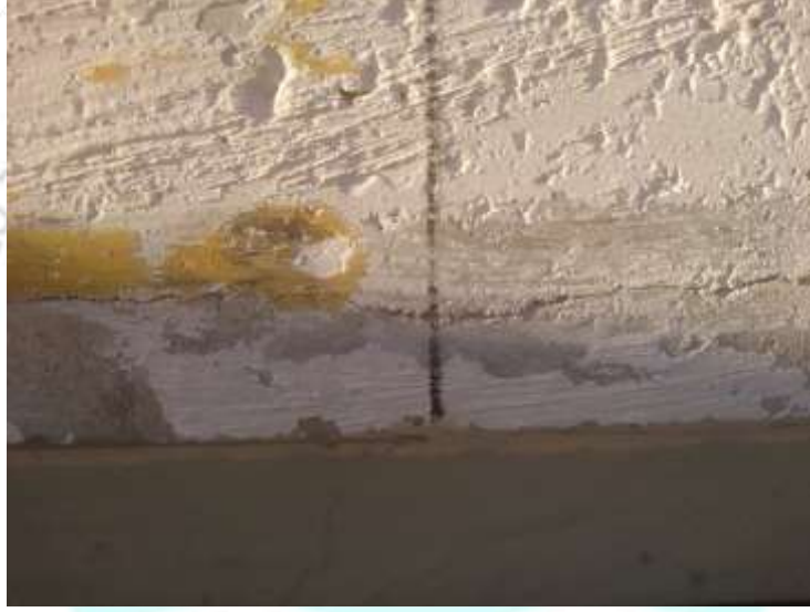
Görsel 20. TT-Kiriş Uçlarına Yakın Bölgelerde Kiriş Tabliyesi ile Yapısal Kaplama Betonu Arayüzündeki Kılcal Kayma Çatlağı
