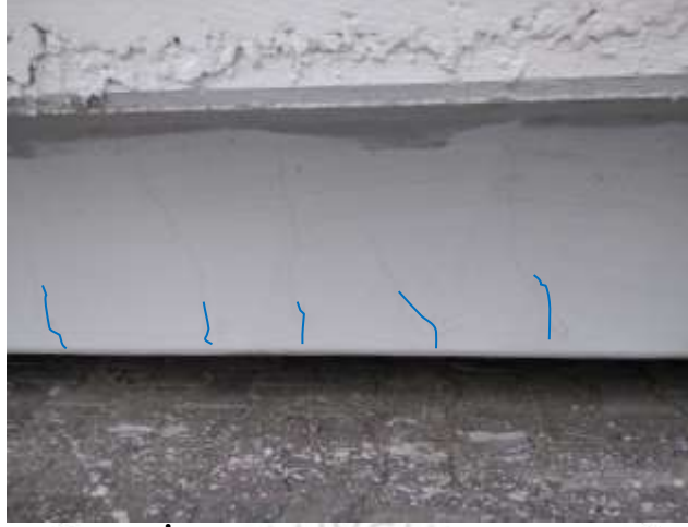
Görsel 19. TT- Kiriş Tabliyesi ile Yapısal Kaplama Betonu Ara Yüzüne Ulaşan Eğilme Çatlakları
