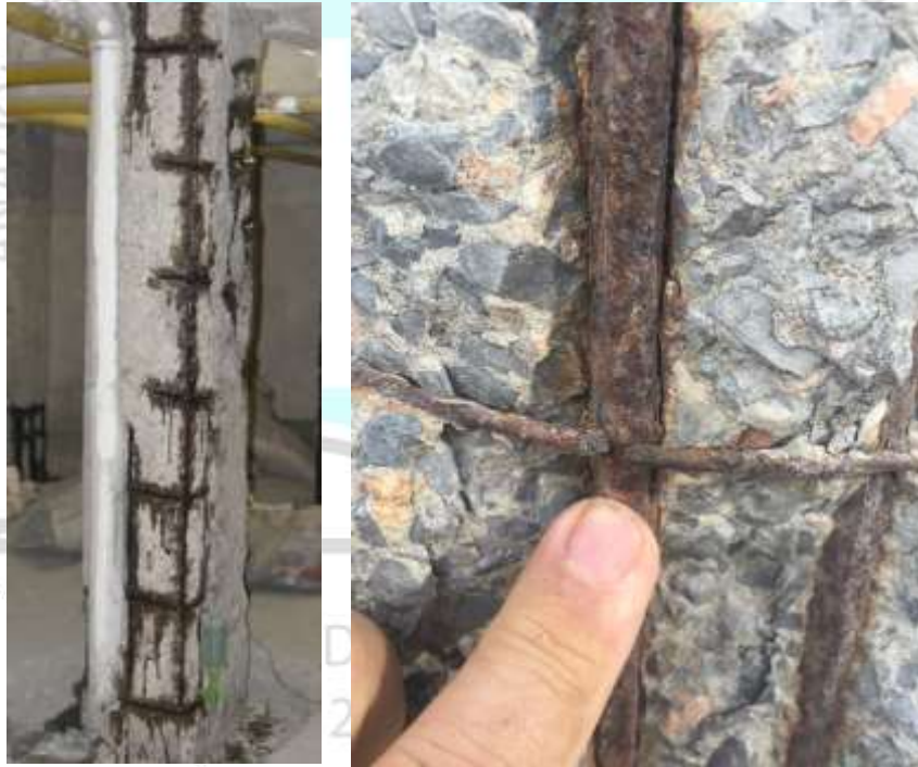
Görsel 3. Korozyona bağlı hasarlı betonarme elemanlar [25]
