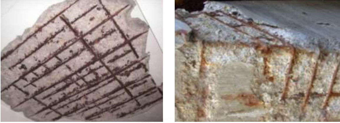
Görsel 2. Yapıda korozyona bağlı paspayı ve doantı kaybı [14]
